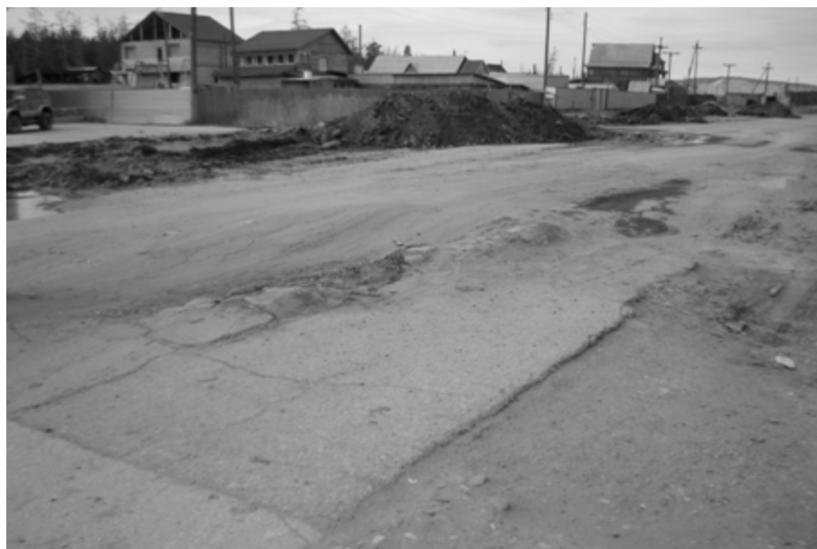
Рис. 1: Пучение, просадки, пльвунные грунты
